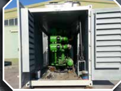
JENERATÖR KONTEYNER (GENERATOR CONTAINER)
